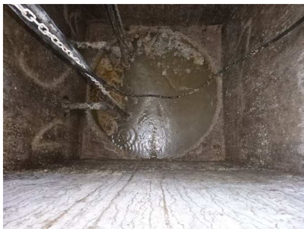
PR Broindon Lagune - Puits de refoulement
