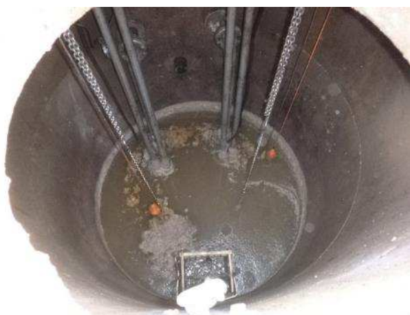
PR Savouges Route de Noiron - Puits de refoulement
