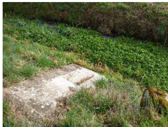
PR Saulon la Milleraie Exutoire trop-plein
