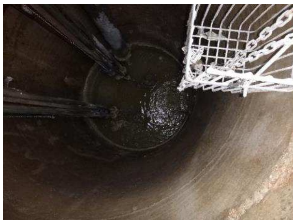
PR Saulon la Chapelle, Salle de l'Union - Puits de refoulement
