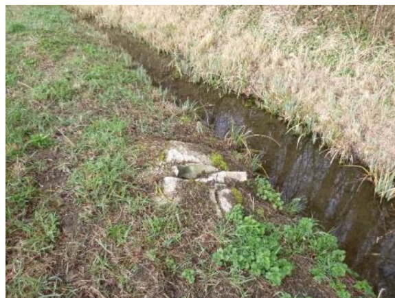
PR Saulon la Sans Fond Exutoire trop-plein
