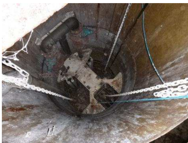
PR Noiron sous Gevrey - Puits de refoulement
