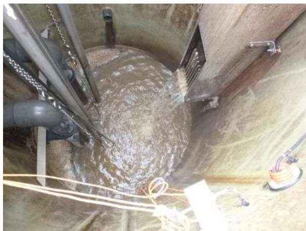
PR UDEP Noiron-sous-Gevrey – Puits de refoulement
