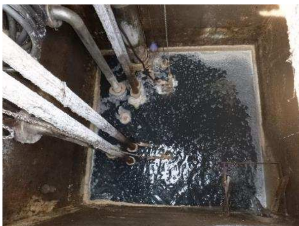
PR Lavoir - Puits de refoulement
